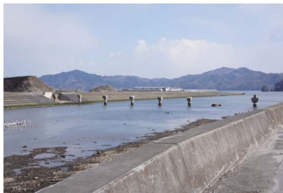
津波により被災した橋梁
